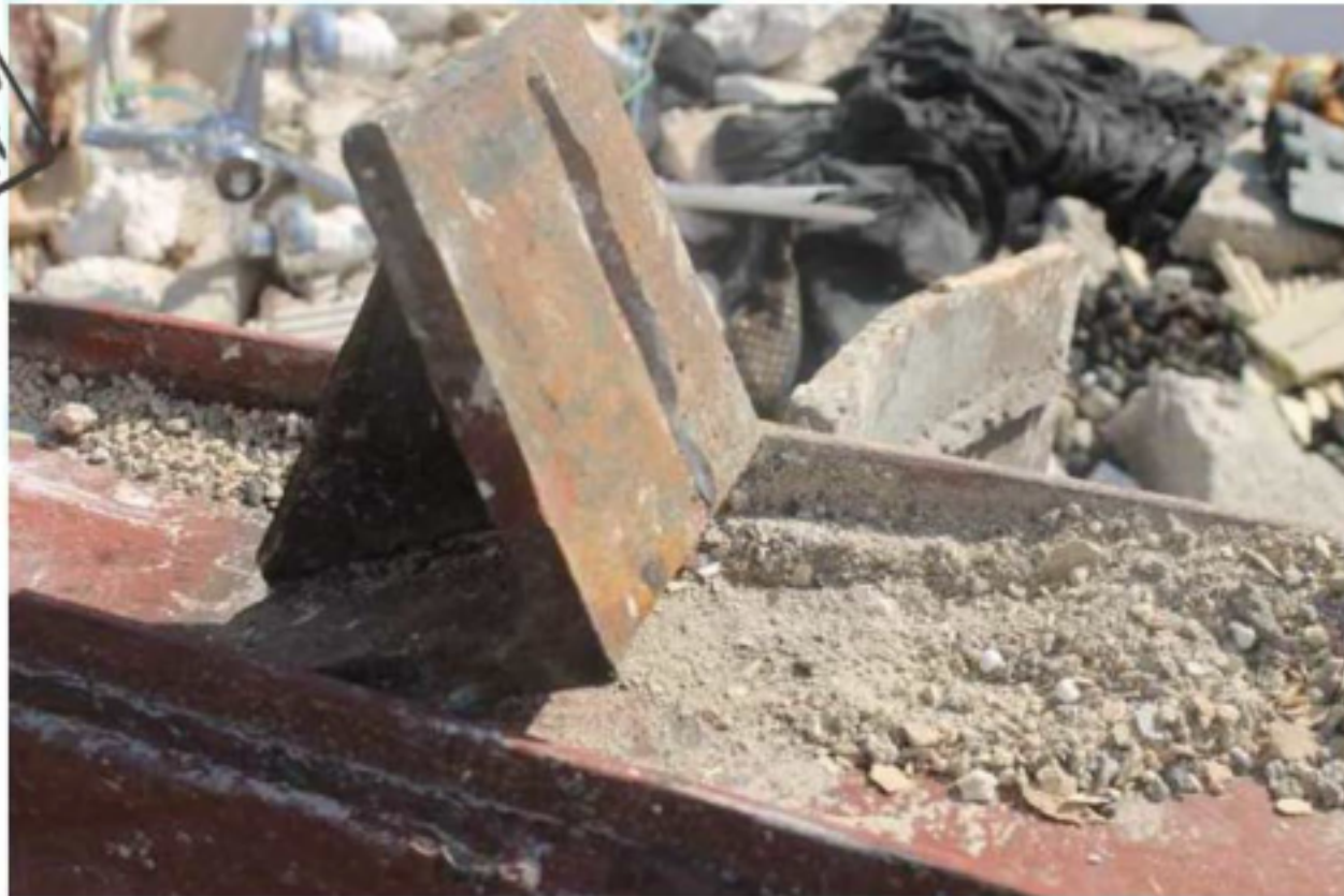
شکل ۵-۳۴ عدم نفوذ جوش اتصال گوشه نبشی به ستون
