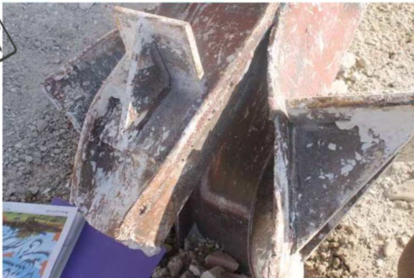
شکل ۵-۳۶ عدم جوش مناسب صفحه اتصال به ستون
