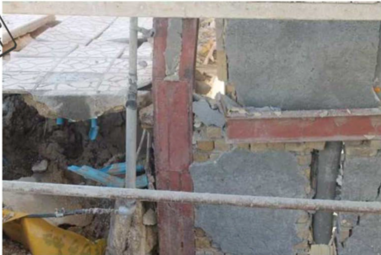
شکل ۴۰-۵ اتصال نامناسب تیر به ستون
