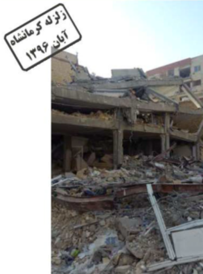
فرو ریزش ساختمان فلزی ۴ طبقه ناشی از طبقه نرم
