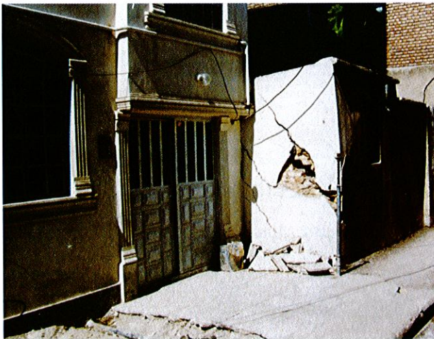
تصویر ۷-۱۳- ترک ایجاد شده در ساختمان قدیمی در مجاورت ساختمان جدید
