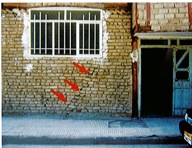
تصویر ۷-۱۶- ترک ایجاد شده در دیوار خارجی ساختمان، در مجاورت شکستگی لوله آب
