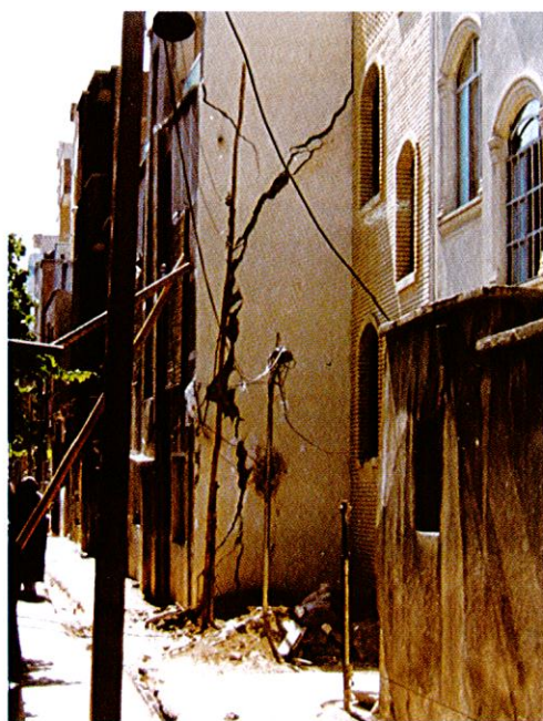
تصویر ۷-۱۵- ترک ایجاد شده در ساختمان موجود، در کنار ساختمان جدید
