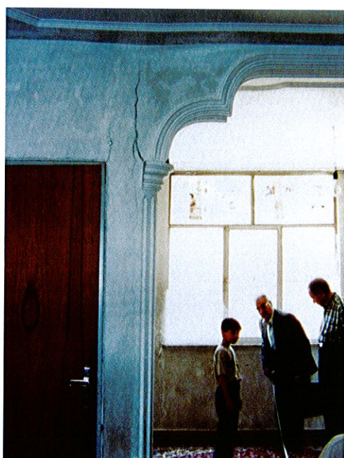
تصویر ۷-۱۹- ترک ایجاد شده در قسمتی از آرک تزئینی که ارتباطی با نشست قسمتی از ساختمان ندارد.
