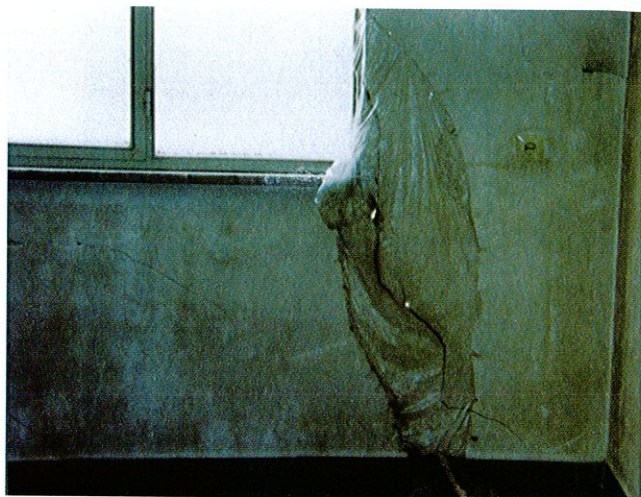
تصویر ۷-۱۸- ترک ایجاد شده در دیوار به علت نشست
