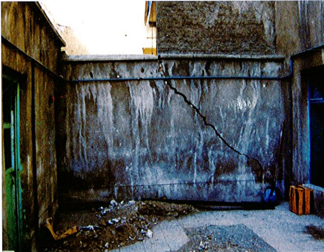
تصویر ۷-۱۲- ترک های ایجاد شده در دیوار حیاط، ناشی از نشست ساختمان
