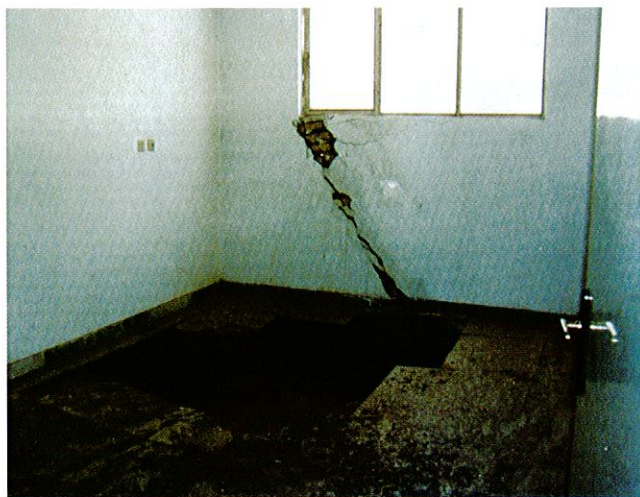
تصویر ۷-۱۷- ترک ایجاد شده در دیوار بعثت ایجاد نشست در دیوار به طرف خارج ساختمان، با دید از داخل ساختمان، همچنین حفره ایجاد شده در داخل ساختمان در نتیجه ی نشت آب از لوله ی آب شهری
