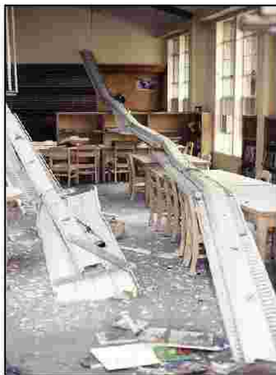
شکل ۱۰-۳- آسیب به سیستم روشنایی در هنگام زلزله
