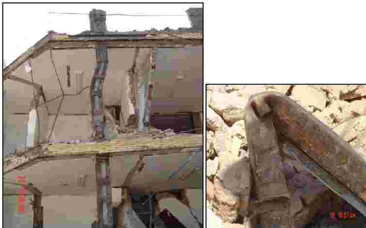
شکل ۲-۵-۳-۱۹- نمونه‌ای از خرابی ستون‌های فولادی
