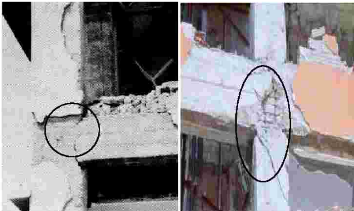
گسیختگی برشی در ناحیه تیر در بر اتصال
