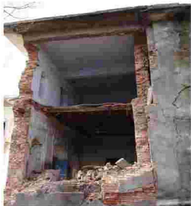
خرابی به علت ضعف در محل اتصال دیوار به دیوار فوقانی
