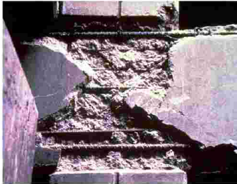
شکل ۲-۶-۸ کمانش میلگردهای طولی تیر در ناحیه اتصال
