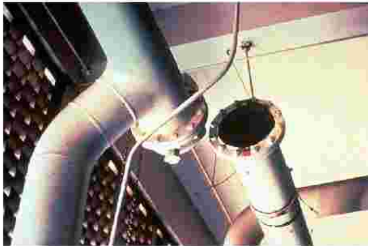
شکل ۱۰-۱۴ - نمونه‌ای از آسیب وارد شده به تاسیسات لوله‌کشی در زلزله‌های گذشته
