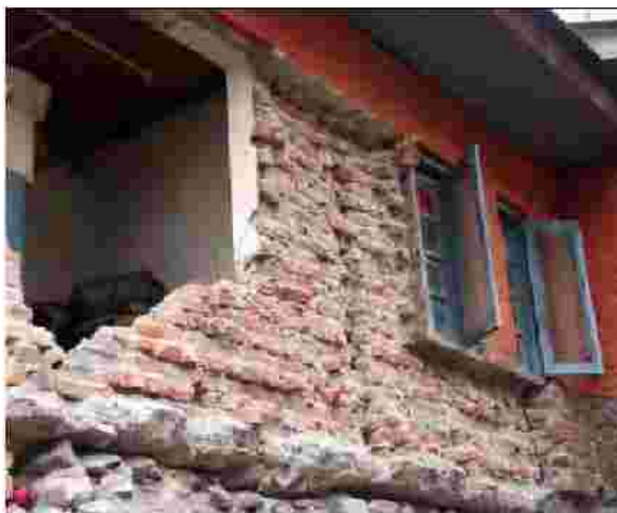
شکل ۹-۶ نمونه‌ای از خرابی خارج از صفحه دیوارهای بتنی
