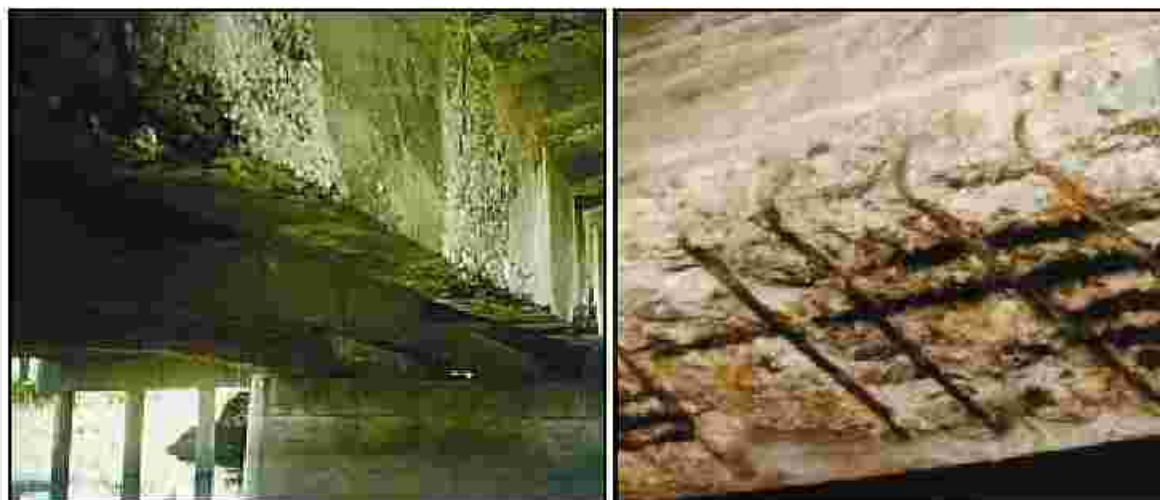
شکل ۲-۴-۱- نمونه‌هایی از آسیب‌دیدگی تیرهای بتنی
