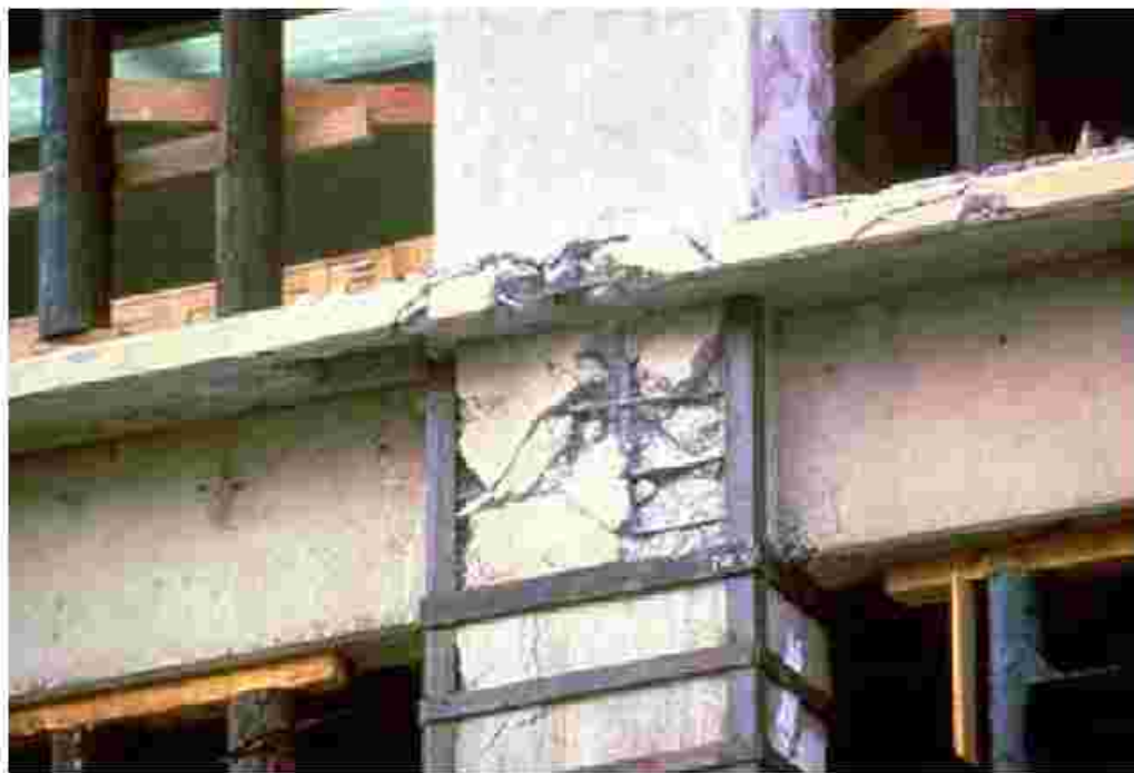
شکل ۲-۶-۷ کماتش میلگردهای طولی ستون در ناحیه اتصال
