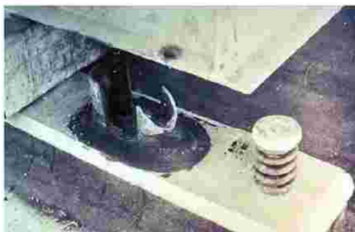
شکل ۹-۱۰- آسیب وارده به جداگر فنری در زلزله
